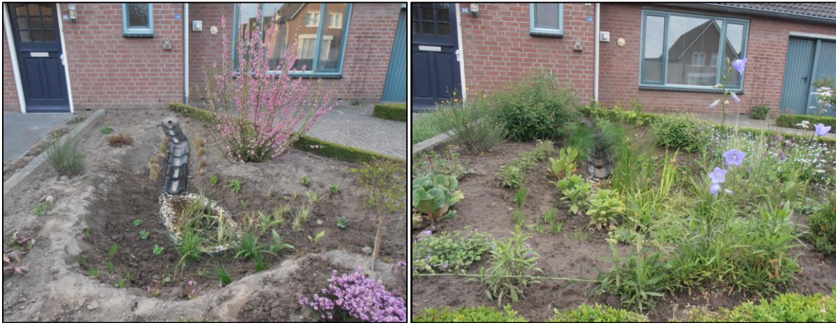
Figuur 80: Regenwater naar wadi in voortuin (links: aanleg wadi, rechts: wadi voltooid) (Bron: Van Eck, G.; [40])
